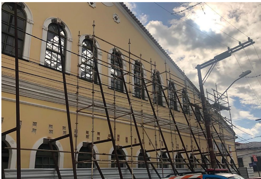
FIGURA 9 - Edificação com escoramento inclinado na área de estudo.
